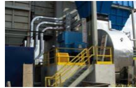
GERDAU AMERISTEEL – Kanada 4 x 900 kW, 4 160 V, 8 P, kostra 8010 (MGP)
